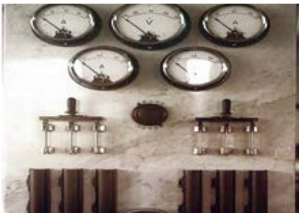
Marmurowa tablica stosowana w dawnych elektrowniach
